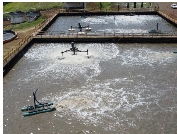
Figura 31 - Detalhe dos aeradores.
