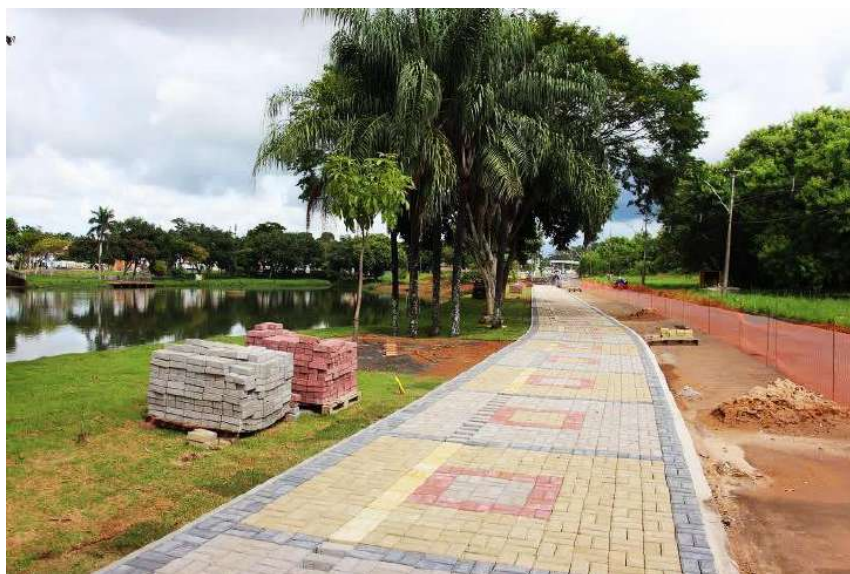
Figura 65: Obras de requalificação do Lago Artificial “Ophélia Borges Silva Alves”. Fonte: Prefeitura Municipal de Batatais.
