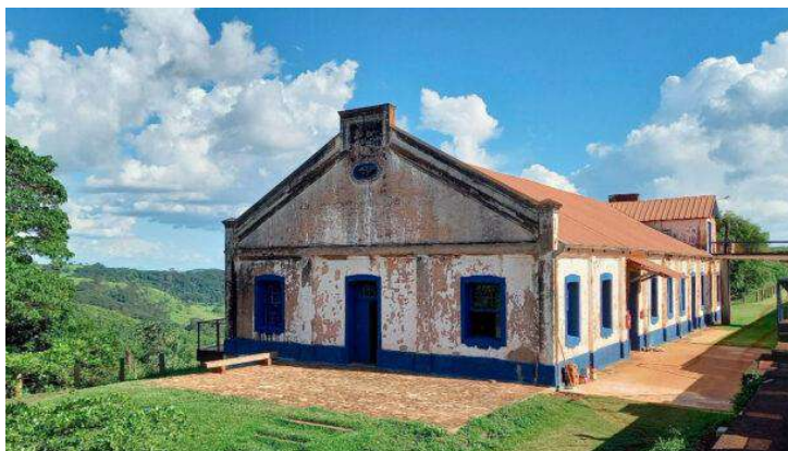
Figura 86: Imóvel centenário da Fazenda Morada da Prata Fonte: Site da Prefeitura de Batatais
